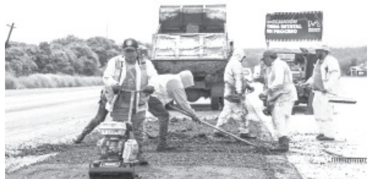
En apoyo al Gobierno de México, la Secretaría de Comunicaciones y Obras Públicas (SCOP) realiza labores de mantenimiento emergente en 19 tramos carreteros de competencia federal que presentan daños severos, en los cuales realiza bacheo superficial, deshierbe y limpieza de cunetas a lo largo de mil 559 kilómetros lineales.
