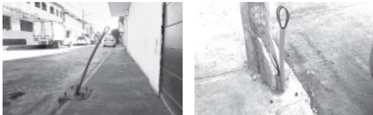
La instalación de luminarias se ha realizado en distintos puntos de la ciudad, pero en algunas partes solo se ha instalado el cableado, dejándolo así desde hace ya varios meses.
