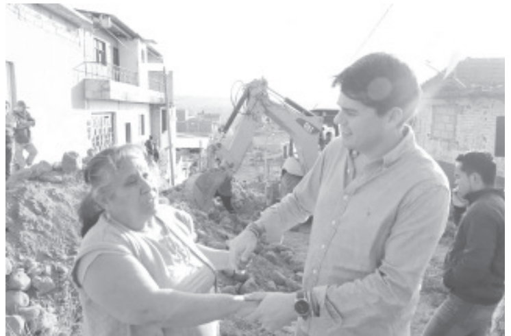
Zitácuaro, Mich., a 21 de diciembre del 2022.- "Más y mejores calles en el poniente de Zitácuaro, después de años de olvido", resaltó el alcalde Toño Ixtláhuac, durante el arranque de los trabajos de pavimentación de la calle Benito Juárez sur, entre Álvaro Obregón y Guillermo Prieto.
