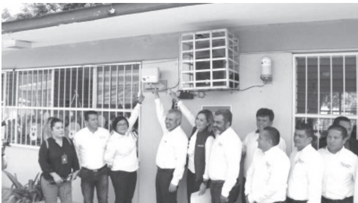
La Secretaría de Comunicaciones y Obras Públicas (SCOP) de Michoacán ha colocado mil 112 equipos distribuidores -antenas- en igual número de bibliotecas, centros de salud y educativos de 65 municipios, como parte del programa Internet para Todos.
