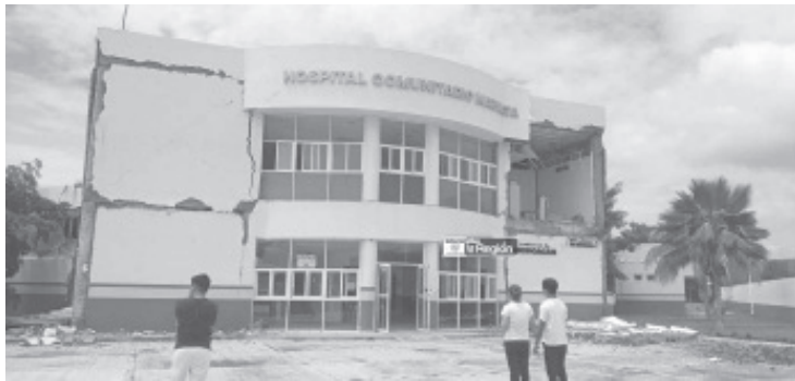
En Aquila, en el Hospital de Maruata se registró la caída de una barda y daños en la estructura del sanatorio.
