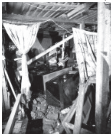
25 domicilios afectados por las lluvias en el municipio de Jungapeo, sin que hasta el momento se registre alguna persona lesionada.
