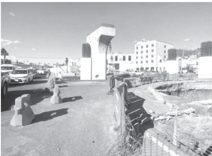
En el distribuidor vial Mil Cumbres, la SCOP del Gobierno de Michoacán, ha formulado una solución para garantizar la seguridad vial, accesibilidad y eficiencia de la construcción.
