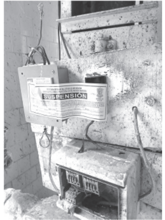
El rastro de Zitácuaro está lejos de cumplir todos los puntos que marca la ley general de salud, para su funcionamiento normal.
