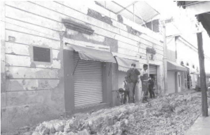
Parte de la barda de la vivienda donde vivió el filósofo zitacuareño Samuel Ramos se vino abajo en la madrugada de este lunes.
