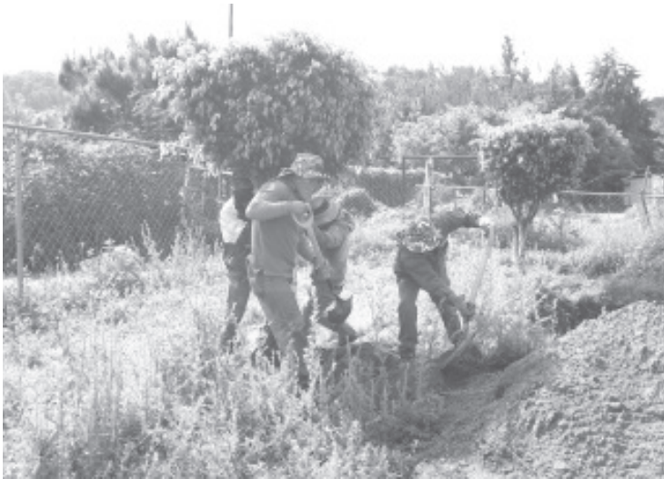
En los terrenos de la feria, en la parte de enfrente ya fueron realizadas varias cepas, para que una vez que lleguen los árboles sean colocados.
