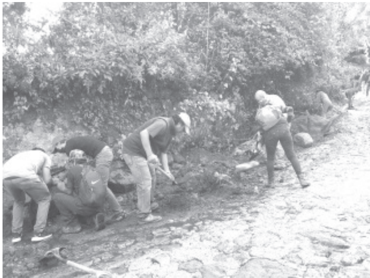
Durante un recorrido se pudo observar el gran arrastre de lodo, piedras de distintos tamaños, así como ramas y mangueras de agua potable rotas.
