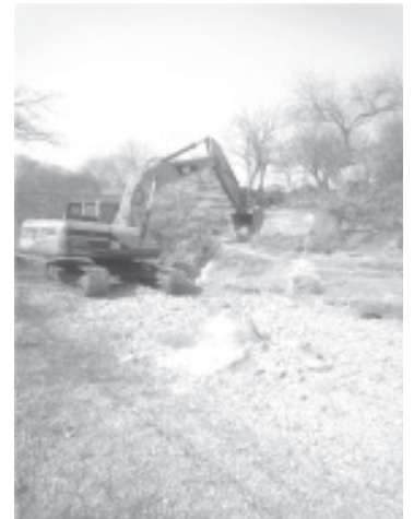
La construcción del puente-vado en Francisco Villa, beneficiará a cientos de familia.
