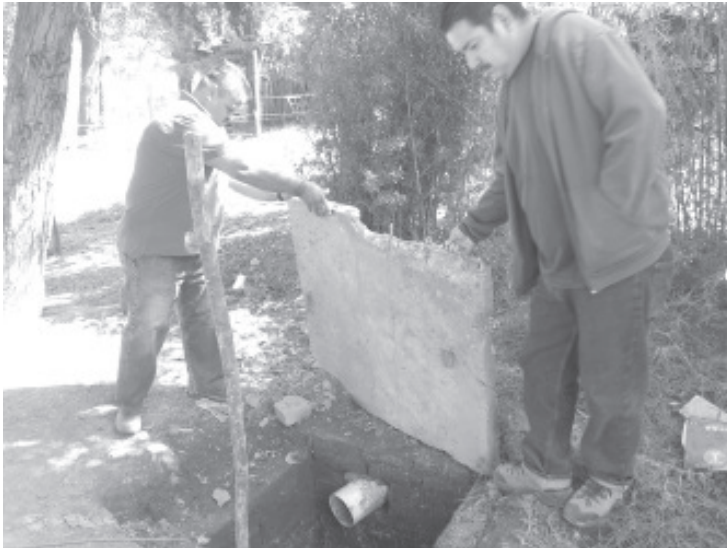
Actualmente el drenaje está tapado y se encuentran a cielo abierto los desechos y urge que la autoridad voltee a ver el problema.
